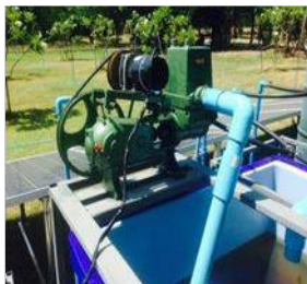
รูปที่ 9 ป้อนน้ำสำหรับระบบให้น้ำแบบสปริงเกอร์และแบบน้ำหยด
