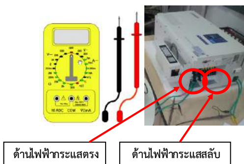
รูปที่ 20 การตรวจสอบแรงดันไฟฟ้าจากเครื่องแปลงกระแสไฟฟ้าทั้งด้านไฟฟ้ากระแสตรงและไฟฟ้ากระแสสลับ
